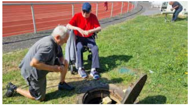
Manfred Schulz und Manfred Gärtner bei der Problemanalyse vor der Zisterne 1 (Foto L.Seq.)
